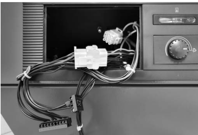
Abb. 104: Getrennte Anschlussstecker für den Regler.
