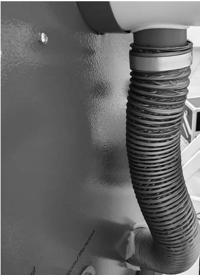
Abb. 12: Zuluftschlauch am Kesselabgasanschluss
