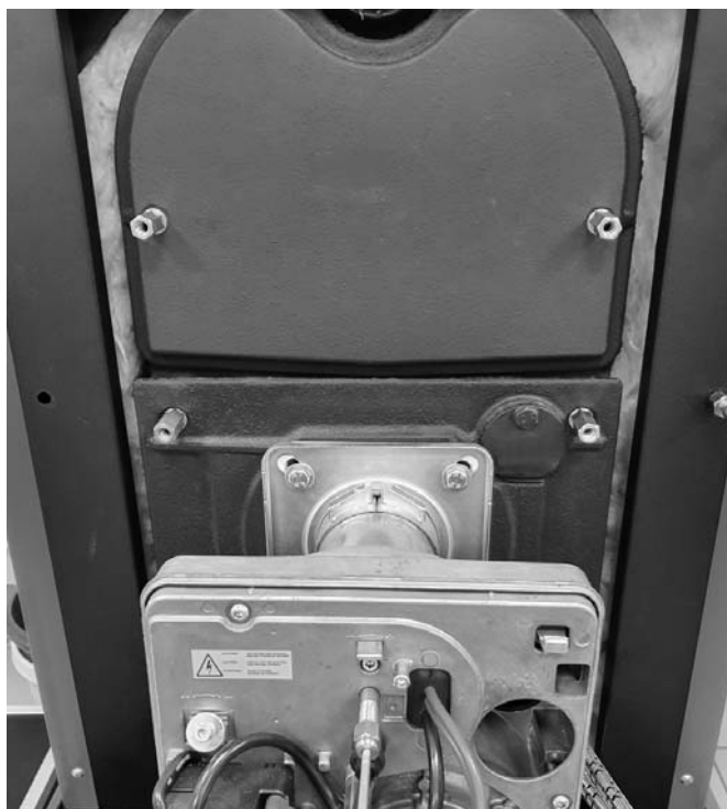
Abb. 84: Obere und untere Kesseltür
