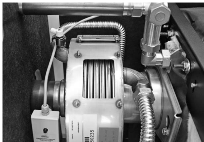
Abb. 88: Reinigungsöffnung des RWT
