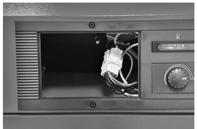
Abb. 29: Offener Reglerschacht mit Steckverbindung für den Regler-Kabelbaum.
